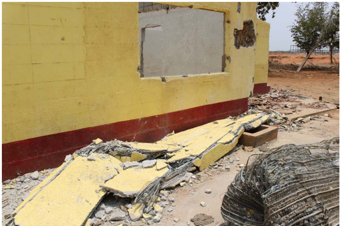
Estado ruinoso de las oficinas de Cresmo C.A. en la obra.
